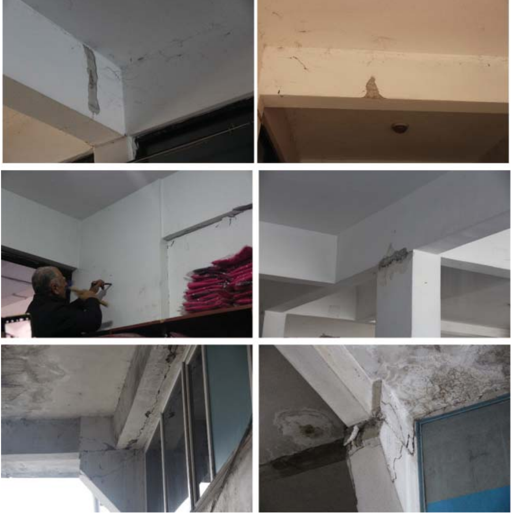
Şekil 11 - Betonarme binalarda yapısal hasar örnekleri (devam)
