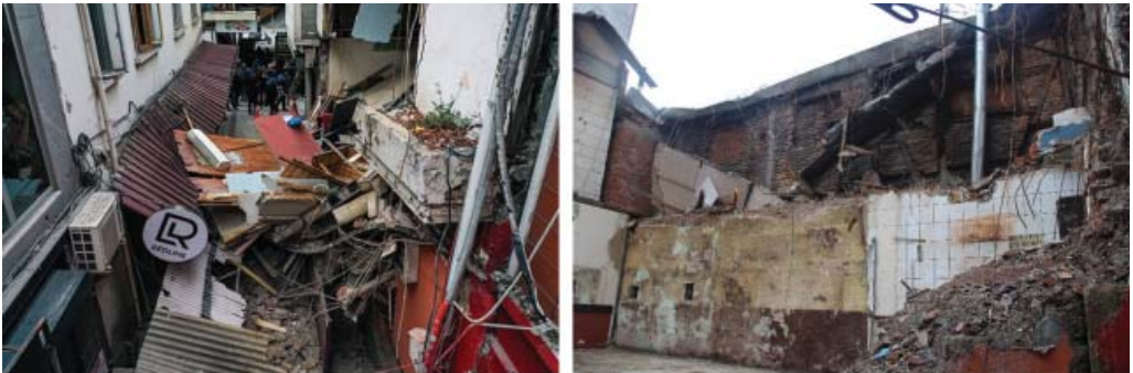
Şekil 12 - Yığma binalarda yapısal hasar örnekleri
