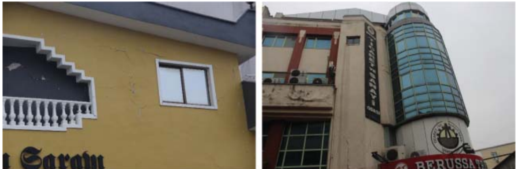
Şekil 10 - Betonarme binalarda yapısal olmayan hasar örnekleri
