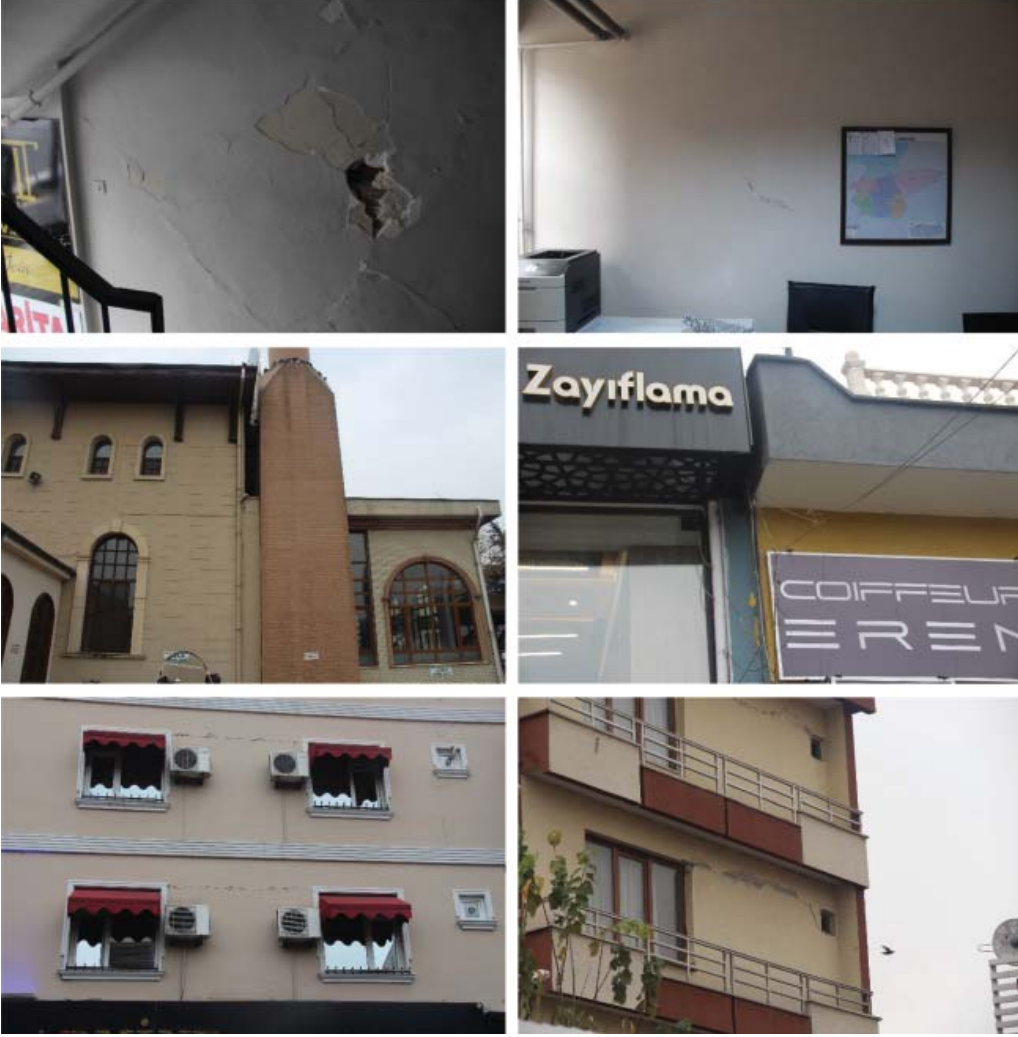
Şekil 10 - Betonarme binalarda yapısal olmayan hasar örnekleri (devam)
